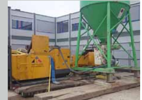
GROUTPOMP T.B.V. GROUTINJECTIE
